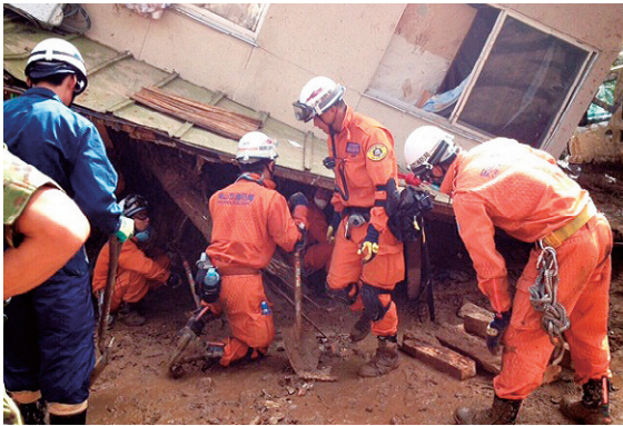
家屋倒壊現場における活動(岡山市消防局提供)
